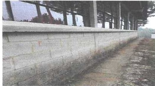
Foto 6: Se observa el poco aprovechamiento de las aguas pluviales en el modulo 1
