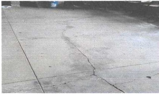
Foto 3: Se observa deterioro en los pisos en el modulo 1
