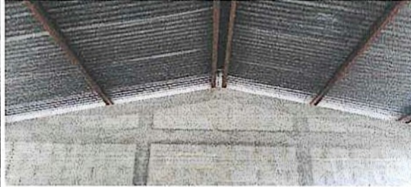
Foto 2: Se observa deterioro en la estructura portante en el modulo 1
