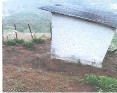
Foto 4: Se observa el deterioro en la estructura y lámina en el modulo 2
