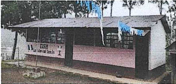
Foto 1: Se observa deterioro en las láminas en el modulo 1
