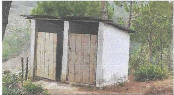
Foto 5: Se observa deterioro en las puertas en el modulo 2
